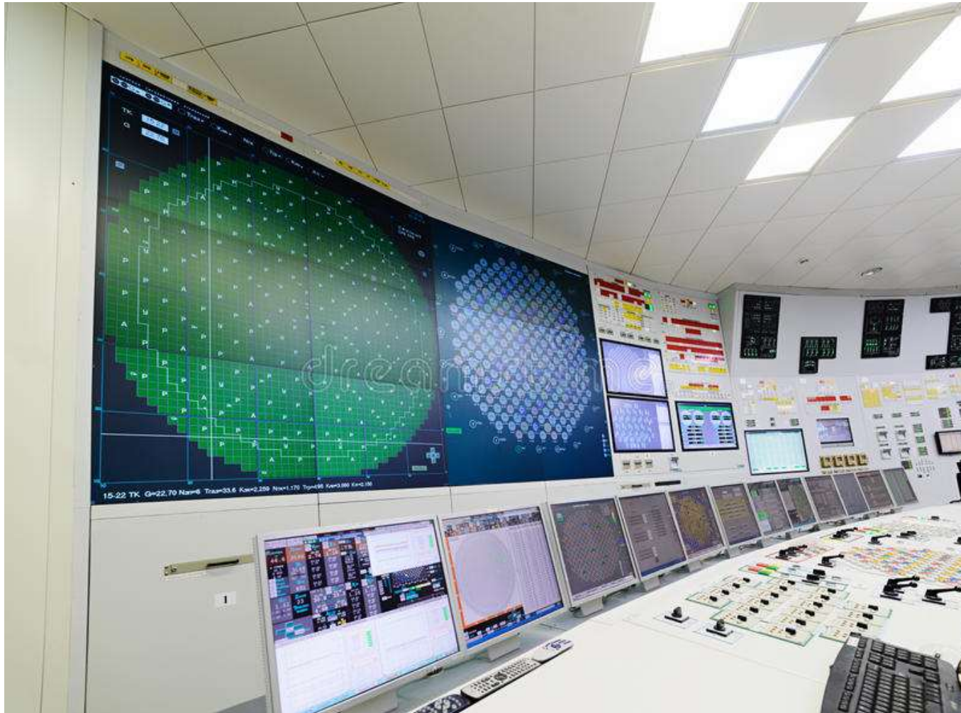
Salle de contrôle d'une centrale nucléaire
